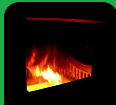
Foyer d'une chaudière à bois produisant de la vapeur pour une turbine, Brésil. © F. Pinta, Cirad
